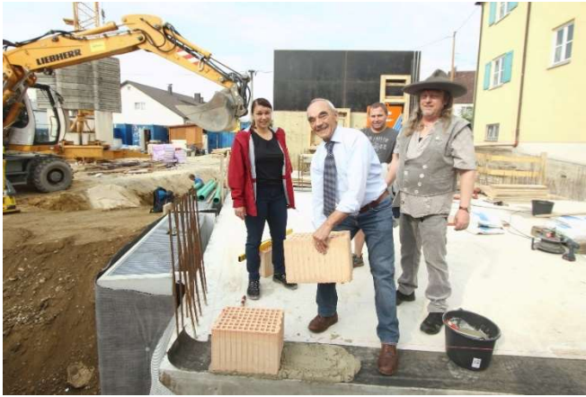
Bei der Grundsteinlegung am 30. August 2018 legte der Bürgermeister selbst mit Hand an. Links: Bauleiterin Katharina Rau vom Büro Axmann-Weiß, die das Projekt betreute.
